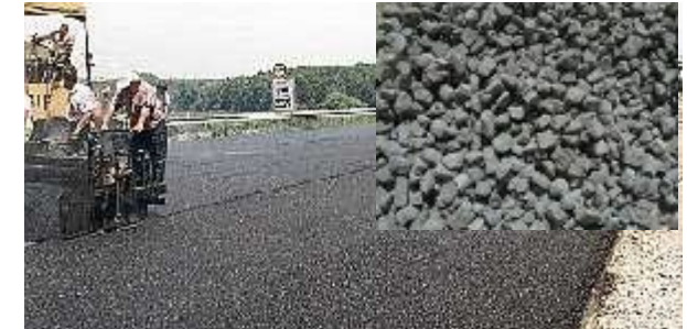
EOS als Gesteinskörnung für Asphalte
