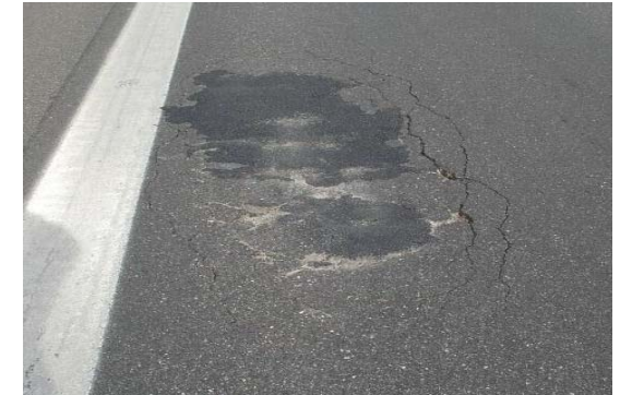
Beispiel für Schäden an Straßenoberflächen
